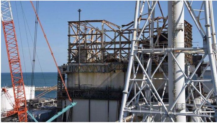
水素爆発で損傷した1号機の原子炉建屋（写真：代表撮影）
