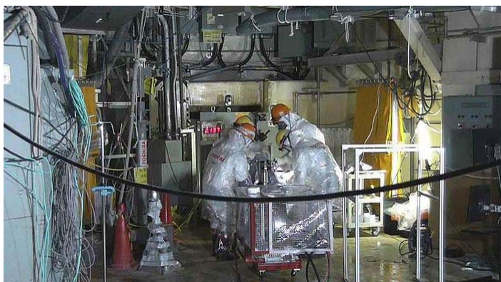
2号機の格納容器に内部調査用の装置を挿入する作業員。被曝を伴う作業だ（写真：東京電力ホールディングス）
